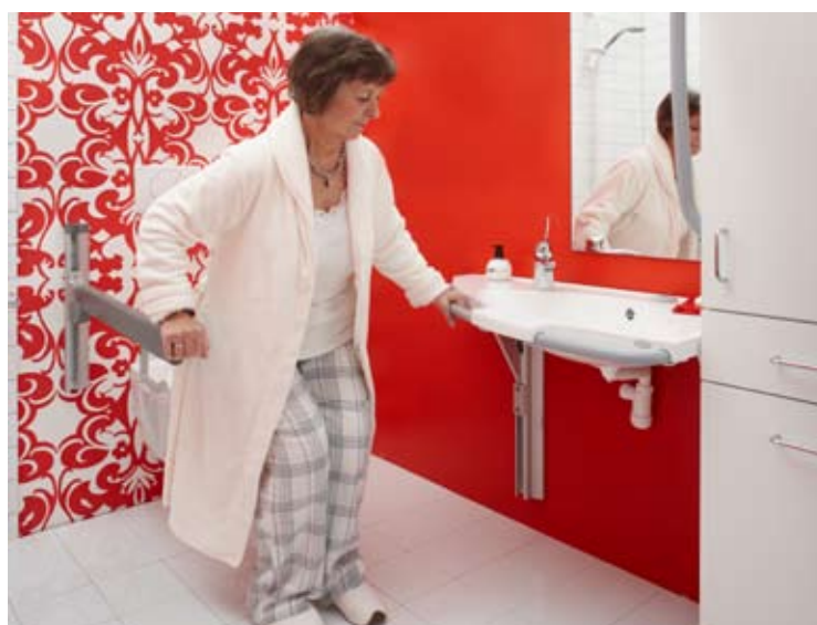
Integrert støttehåndtak på servanten gjør det trygt å komme seg fra toalett til vask.
